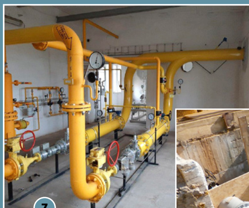
Provoz Energetika Regulační stanice plynu
