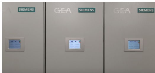
Nové rozvaděče pro MEO
