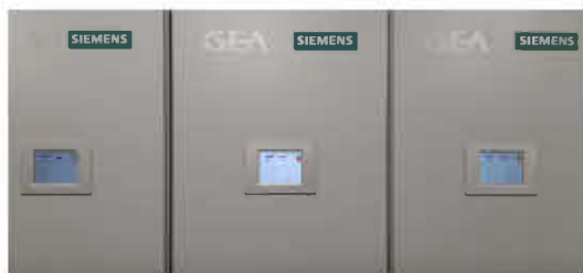
Nové rozvaděče pro MEO
